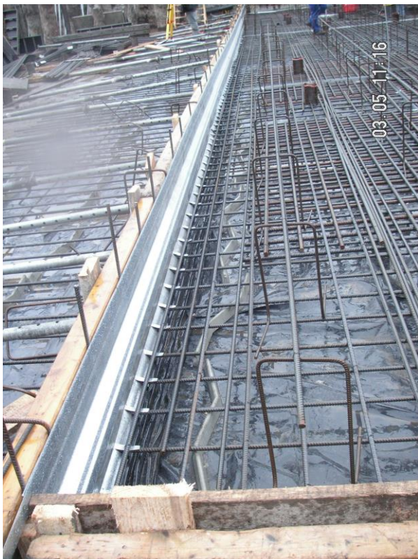
Fot. 9 Przerwa robocza/skurczowa w płycie
