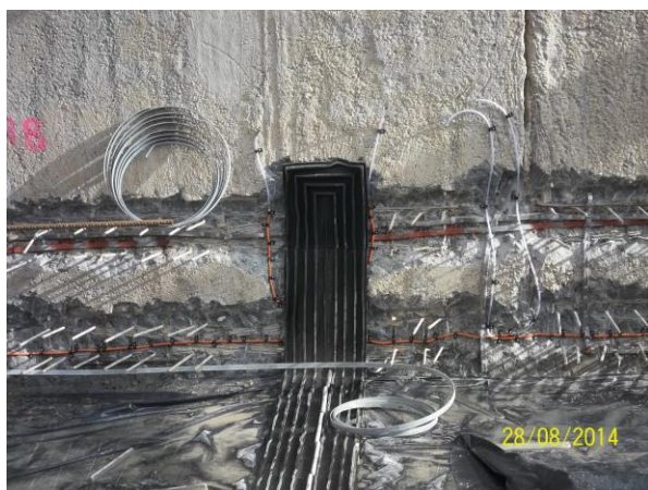
Fot. 29 Przerwa robocza/skurczowa w płycie na styku z zamkiem w ścianie szczelinowej
